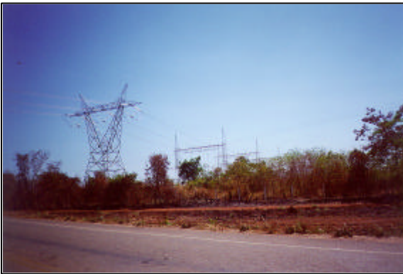
Gurupi – Vista da Subestação da Interligação Norte-Sul.
